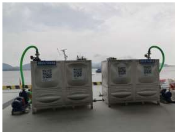
船舶含油废水、生活污水储存罐
