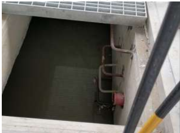
码头雨水收集池
