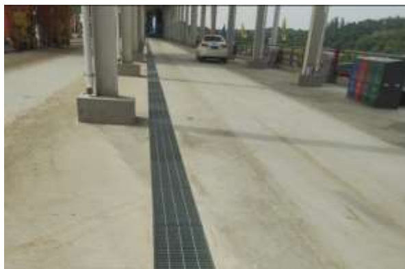
码头平台废水收集沟
