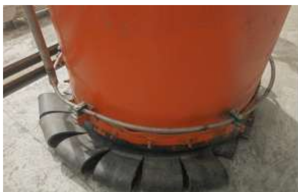
装船机出料溜桶防尘帘及喷雾
