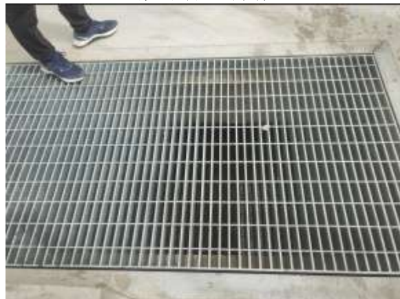
码头雨水收集池
