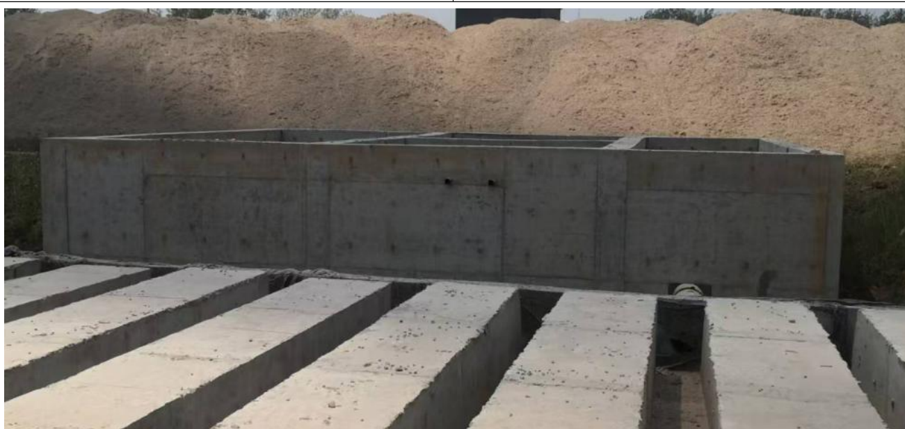
洗车槽及沉淀池
